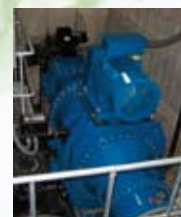
小水力発電設備
