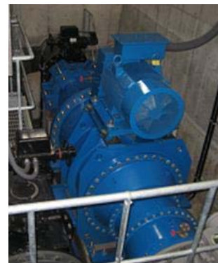
小水力発電設備
